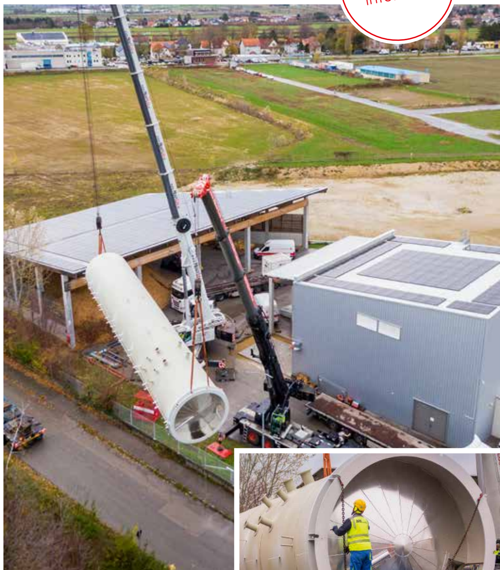
Die neue Großwärmepumpe kann über die Sommermonate 2.000 Haushalte umweltschonend versorgen.
