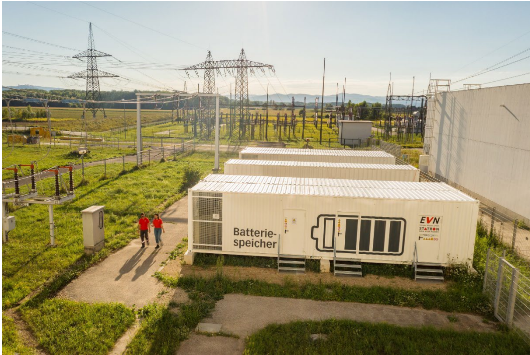
5 MW Großbatteriespeicher in Theiß
